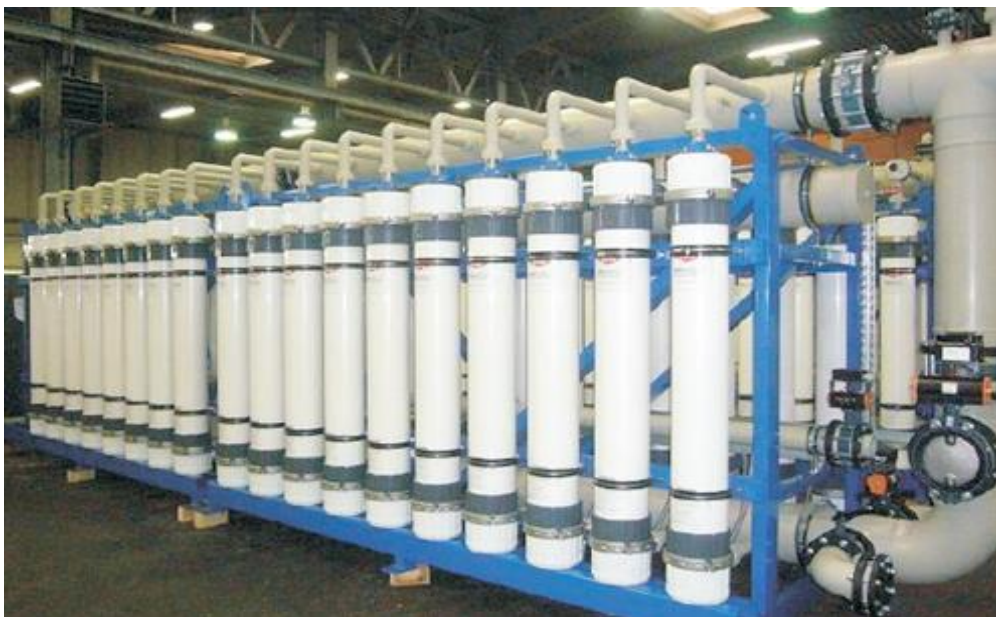
超滤设备实物图
