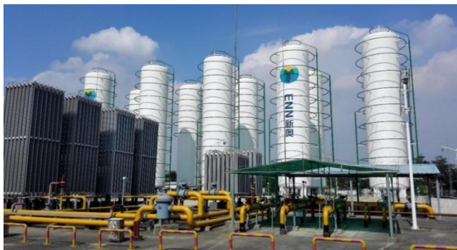
公司天然气厂站
