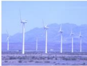
塔城发电（风力发电厂）
