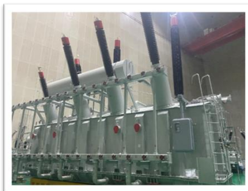
项目名称：尼日利亚某电网项目 变压器规格：300MVA/330kV 开关型号：SHZVIII-1000Y/72.5B-10193W
