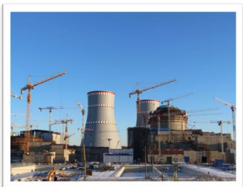
项目名称：孟加拉某核电站项目 变压器规格：533MVA/420kV 开关型号：SHZVI-2400/126D-1223W
