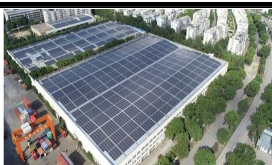
宁波金田铜业 BIPV20MW 光伏电站
