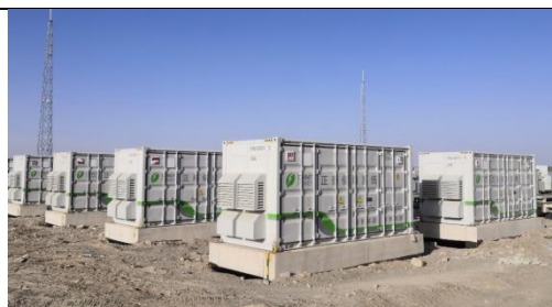
甘肃阿克塞、高台 160MWh 储能电站
