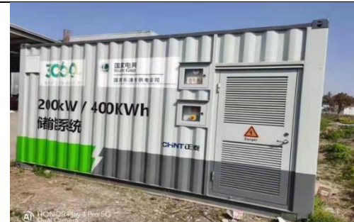
浙江温州 10MWh 储能电站
