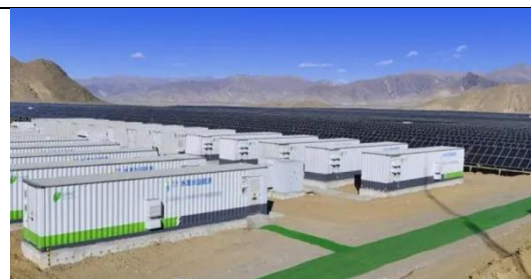
西藏日喀则 100MWh 储能电站
