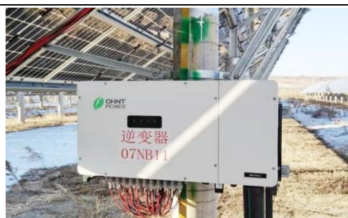
阜新 70MW 光伏发电电站
