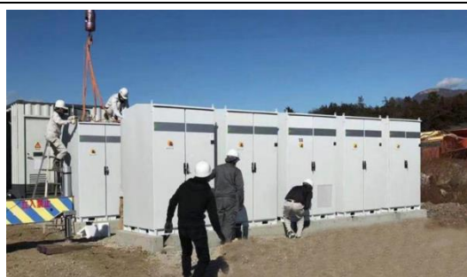
日本群馬 2.15MWh 储能电站
