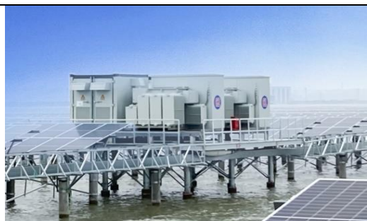
温州泰瀚 550MW 渔光互补电站
